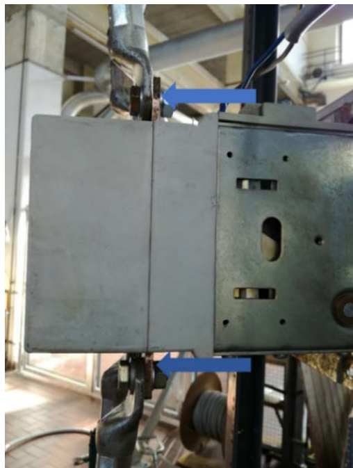
Fig. 35°. Terminali di connessione del contattore su cui sono state eseguite le misure di temperatura.
